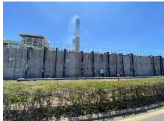
废水处理设施区域 (2)
