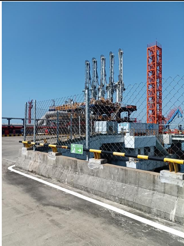
码头（LNG 卸船臂、气体返回臂）
