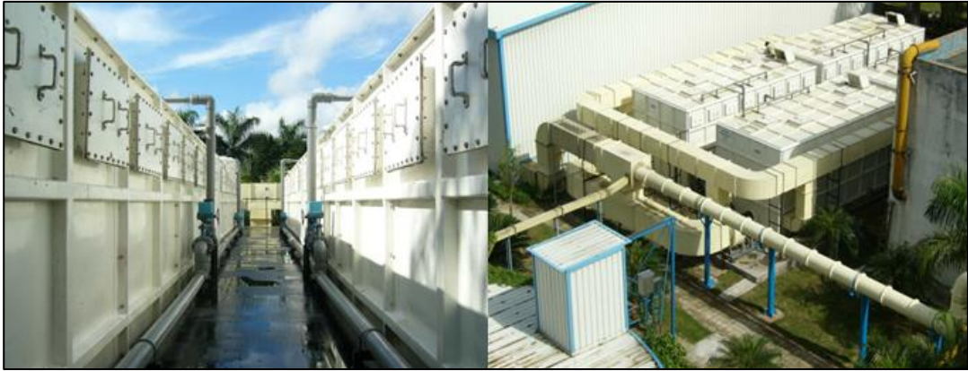
图 4-2 生物除臭工程实例
